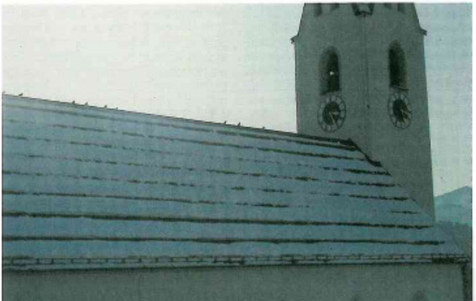
Bild 6.: Durch flächenmäßig verteilte Rohre bilden sich einzelne Schneefelder, so daß selbst bei Steildächern eine Flächenspannung kaum mehr vorhanden ist.
