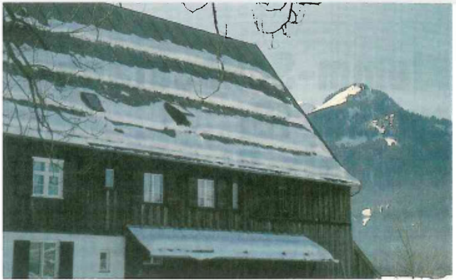
Bild 5.: Gerade in Höhenlagen, wo eine große Gewichtsbelastung bei entsprechenden Schneehöhen entsteht, muß auf die strikte Einhaltung des Haftabstandes geachtet werden.
