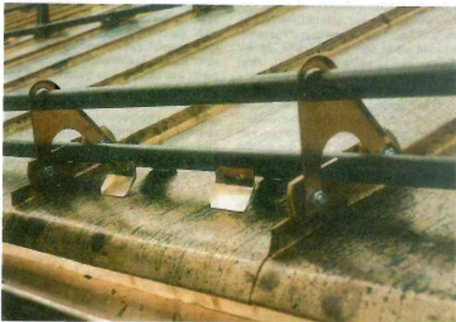
Bild 2.: Die hier abgebildeten Schneefangrohre bestehen aus Kupfer. Sie werden durch Kupfer-Klemmlaschen auf dem Stehfalzdach befestigt.
